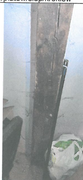
Fot. 10 Widok strychu – spękania wzdluzne pionowe drewna slupa
