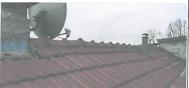
Fot. 5 Widok pokrycia – lekkie falowanie kalenic
