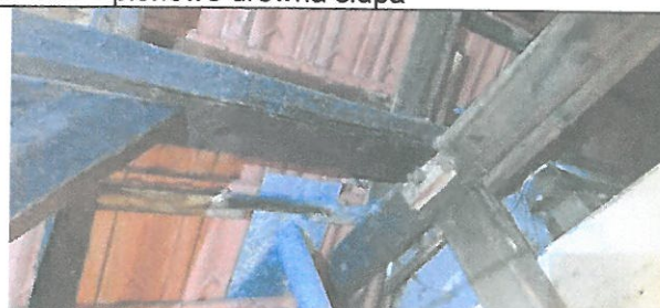
Fot. 12 Widok strychu – spękania wzdluzne drewna platwi
