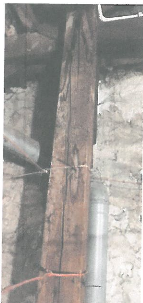
Fot. 7 Widok strychu – spękania wzdluzne pionowe drewna slupa
