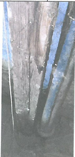
Fot. 9 Widok strychu – spękania wzdluzne pionowe drewna slupa
