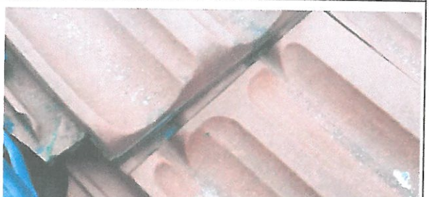
Fot. 4 Widoczna uszkodzona dachówka i powłoka zewnętrzna
